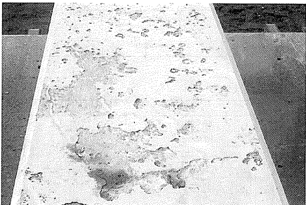
写真-3 表面仕上がり状況（気泡発生）
