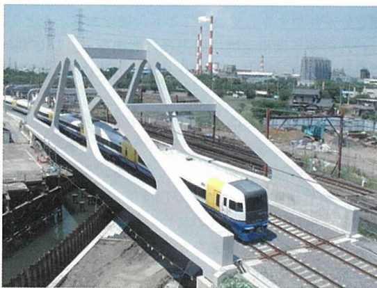
写真 - 9 内房線姉ヶ崎橋梁
