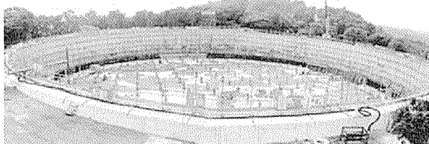
写真 - 6 オイルタンク
