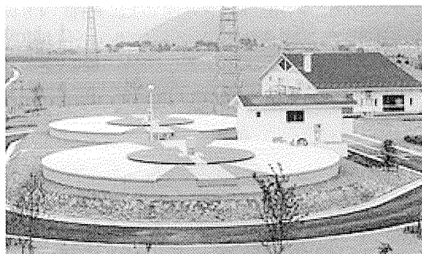
写真 - 7 小規模下水処理槽
