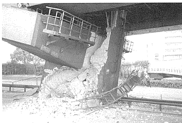
写真-2 RC橋脚のせん断破壊
