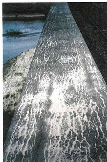
写真 - 7 アルカリ骨材反応による PC 桁の被害
