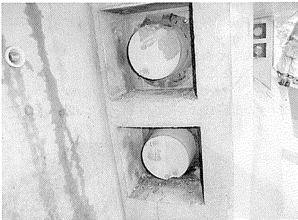
写真 - 2 グラウトキャップ取外し後の状況
