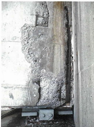
写真-1 凍結防止剤によるPC桁端部の塩害
