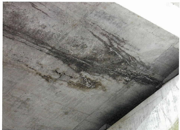
写真-3 PC桁下面に生じたアルカリ骨材反応によるひび割れ
