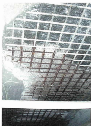
写真-2 凍結防止剤による鋼橋床版の塩害
