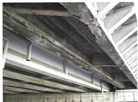
写真 - 3 塩害により劣化した PC 橋の事例
