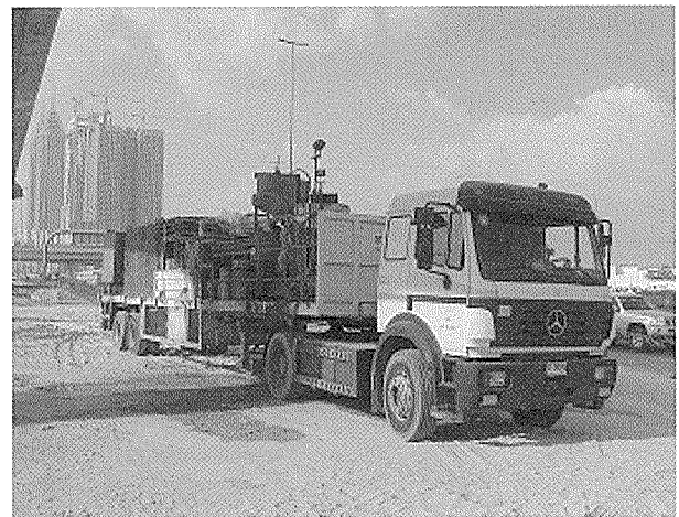
写真 - 11 グラウトプラント台車
