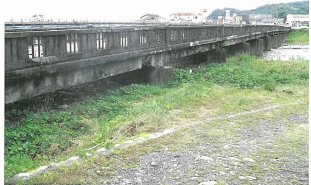
写真-1 塩害により損傷を生じた橋梁
