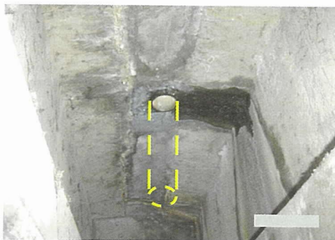
写真-6 塩化ビニル製の排水管が折れてPC主桁に排水がかかる状態 8)
