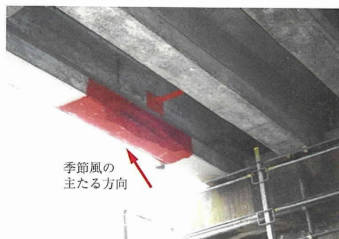
写真-8 季節風により排水が主桁にかかり腐食した事例
