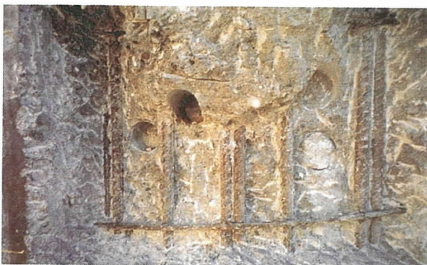
写真-1 旧暮坪陸橋 P 3 橋脚北面の鉄筋 3)
