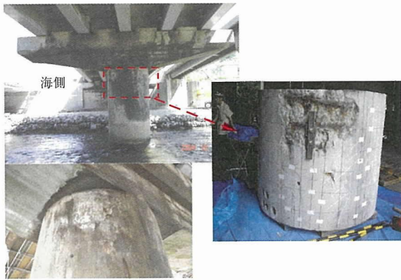
写真-4 撤去直前の橋脚の損傷状況と撤去後のブロック
