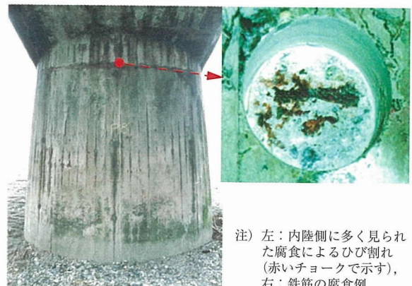
写真-3 撤去される橋脚の鉄筋腐食状況 4)
