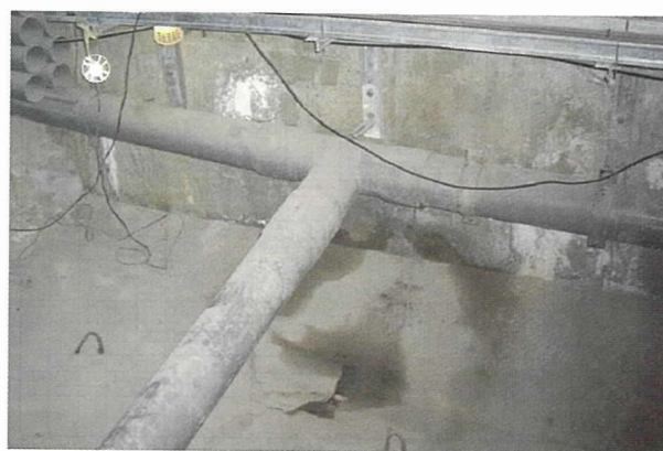
写真-7 箱桁内での配管からの漏水
