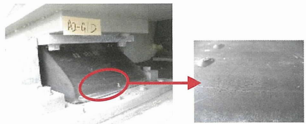
写真-8 地震後180%変形状態と表面の異常部分
