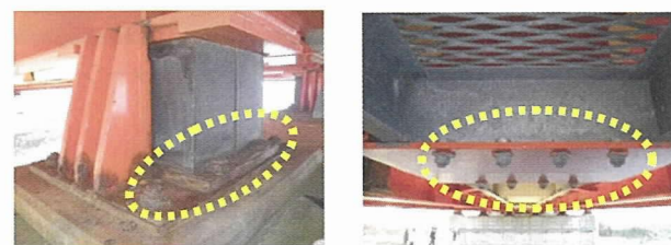
写真-11 温根沼大橋免震支承 写真-12 同亜鉛メッキボルト
