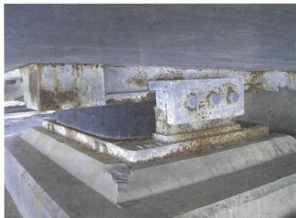
写真-2 溶融亜鉛めっきされたゴム支承のさび発生状況
