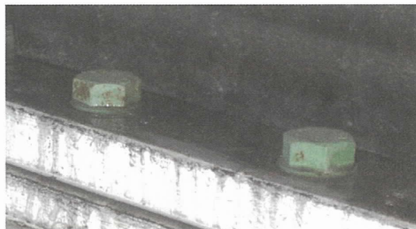
写真-5 フッ素系焼付け処理ボルトのさび発生事例
