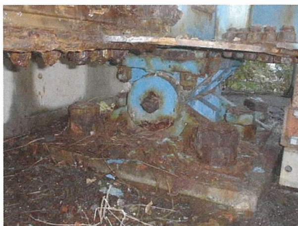
写真-1 伸縮装置からの漏水により生じたさびによる支承損傷事例
