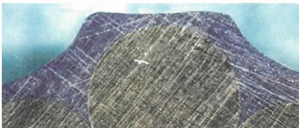
(b) 最大圧潰部分の被覆断面
