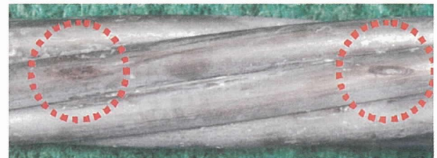
写真-3 フレット痕 (丸枠内に摩耗の痕がみられる)
