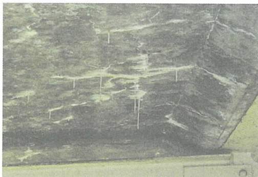
写真 - 6 遊離石灰がツララ状の状況
