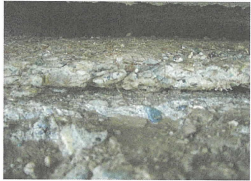
写真 - 7 SFRC と床版の浮き
