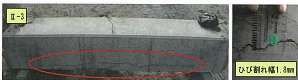
写真-4 Ⅱ-3試験体ひび割れ状況 (2008年4月)
