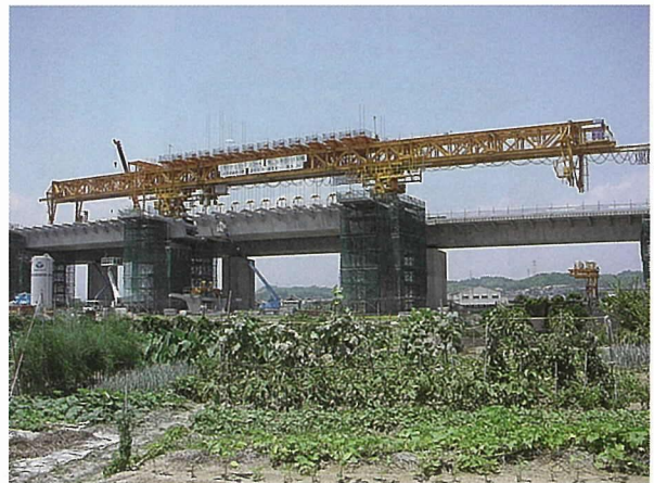
写真-5 スパンバイスパン架設での架設ガーダーの軽量化
