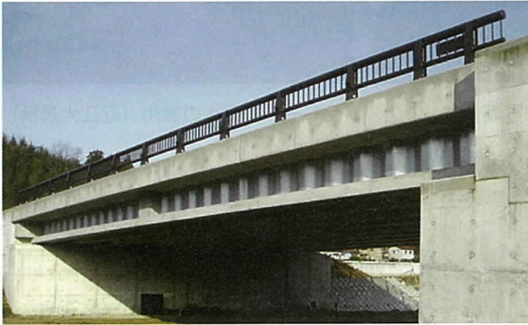
写真 - 4 プレテンションT桁橋への適用（曾宇川橋）
