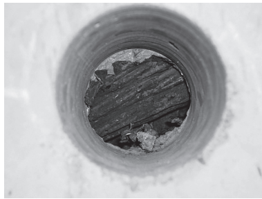
写真 - 1 削孔調査で確認されたグラウト充てん不良例
