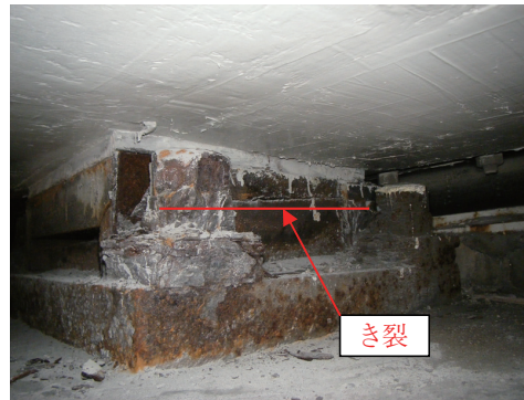
写真-1 サイドブロックのき裂と腐食状況
