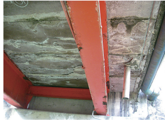
写真 - 2 コンクリートの浮き・漏水
