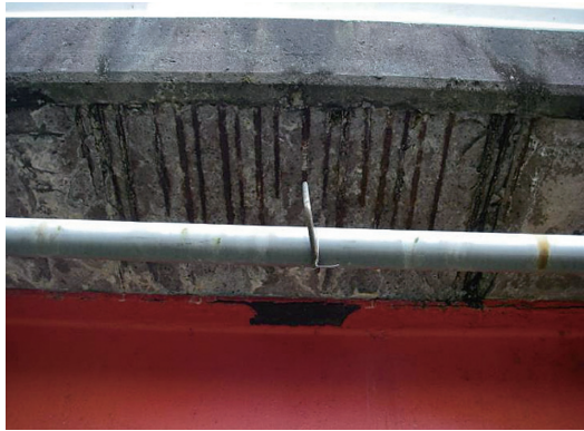
写真 - 1 コンクリートのはく離・鉄筋露出
