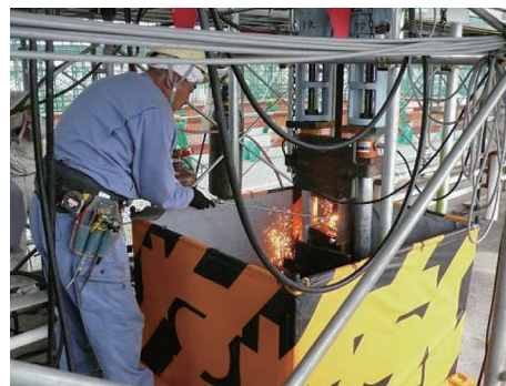
写真-3 PC鋼棒切断状況
