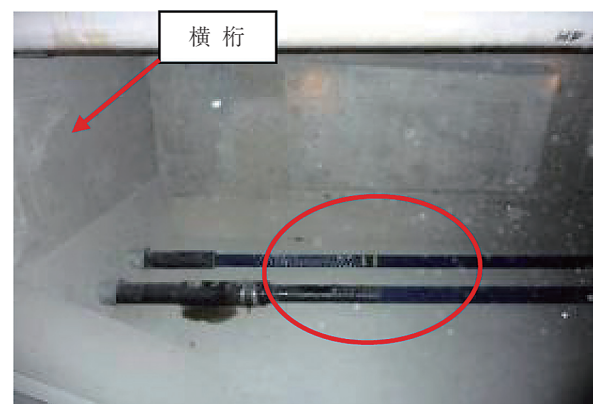
写真 - 3 打痕傷の多い箇所 (A 橋の例)
