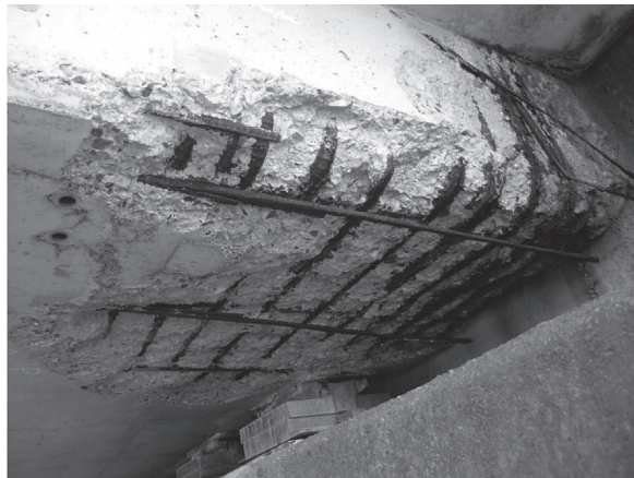
写真 - 4 漏水による桁端部の劣化状況
