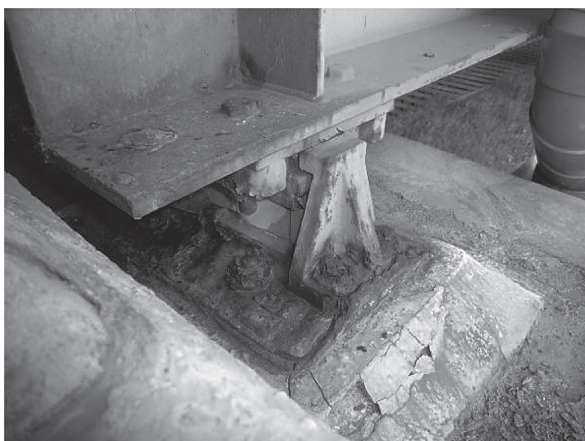
写真 - 8 鋼製支承の腐食状況
