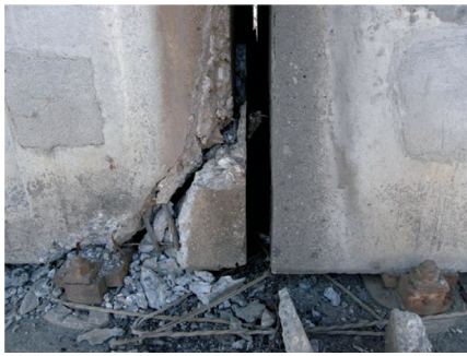
写真 - 3 PC ポステン T 桁橋の桁端部の損傷
