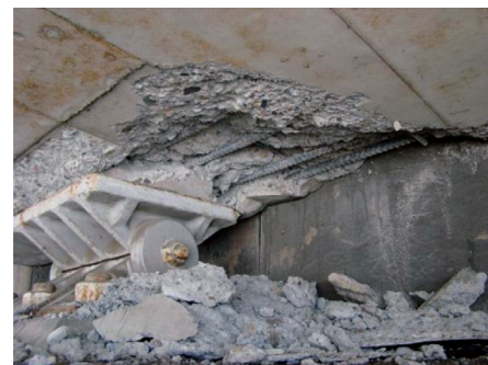
写真-2 支承が取り付けく上部構造（RC中空床版）の損傷
