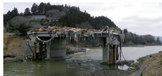
写真 - 8 橋台背面土が完全に流出した橋
