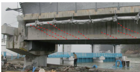
写真 - 7 ポステンPC-T桁のねじりによるひび割れ（写真 - 6の黄色の破線で示す箇所）
