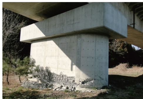
写真-1 RC橋脚の軸方向鉄筋段落し部の損傷
