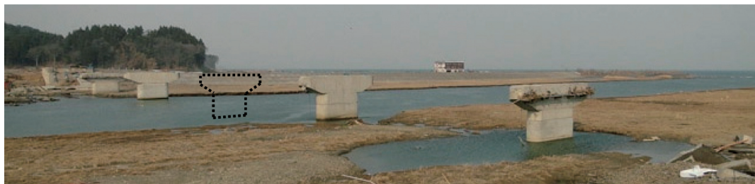
写真 - 5 下部構造（1基）および上部構造の全径間の流出状況（破線部は流出した橋脚があった場所）
