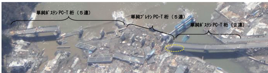
写真 - 6 上部構造の一部径間が流出した橋（写真提供：東北地方整備局）
