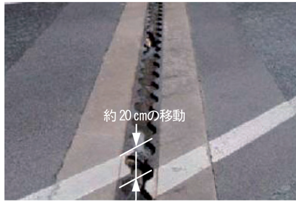
写真 - 3 伸縮装置の損傷状況 (新滑川橋)
