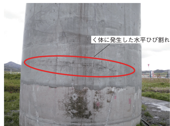
写真 - 3 余震後の橋脚の損傷
