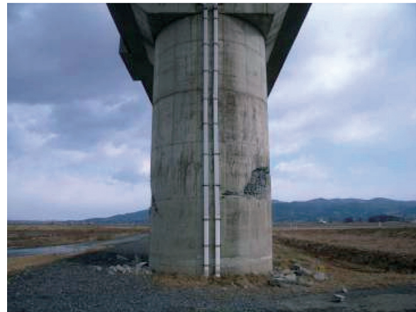
写真 - 1 橋脚の損傷状況
