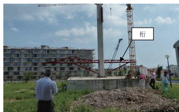
写真 - 3 桁部分が水平になった状況（大学実験場）
