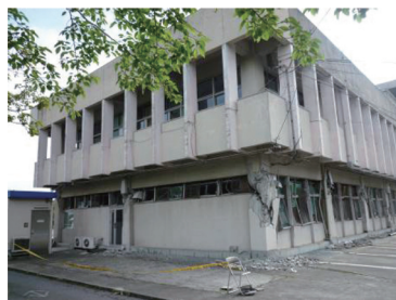
写真 - 3 短柱のせん断破壊
