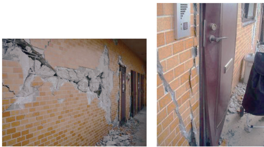
写真 - 7 集合住宅非構造壁の被害
