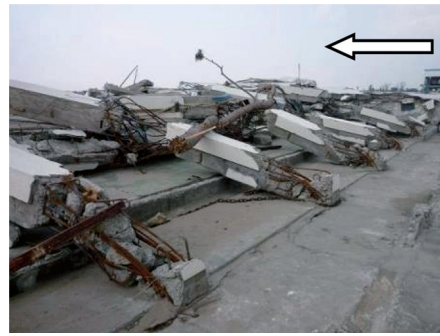
写真 - 8 津波で倒壊した RC 造建築物
