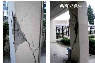
写真 - 4 柱のせん断破壊
