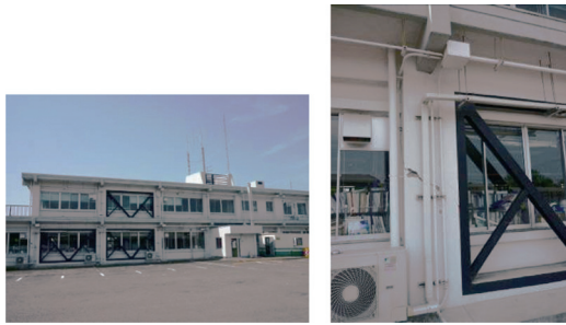
写真 - 6 耐震補強済み建築物の被害
