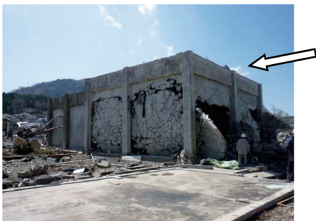
写真 - 11 RC 造壁の破壊
