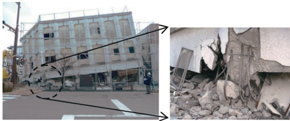
写真 - 1 ピロティ構造建築物の1階層崩壊
