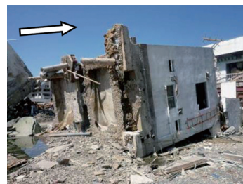
写真 - 10 杭の引抜きを伴って転倒した建築物
