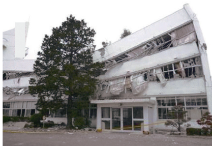
写真 - 2 中間階で層崩壊した建築物
