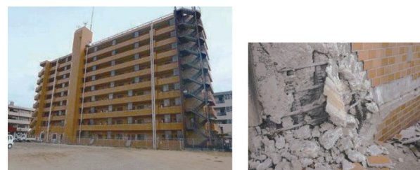
写真 - 5 SRC造建築物連層耐力壁脚部の被害
