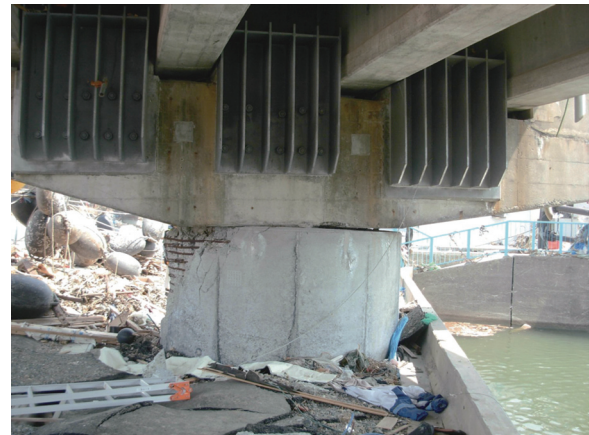
写真 - 7 典型的な曲げによる RC 橋脚の損傷
