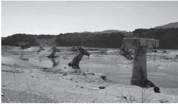
写真 - 9 河川中の RC 橋脚の傾斜
