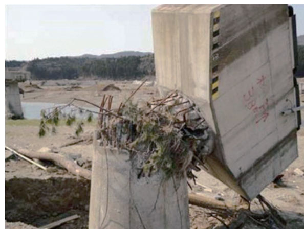
写真 - 8 RC 橋脚横梁部の破壊
