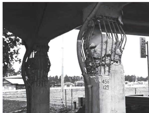
写真 - 1 損傷した東北新幹線の RC 橋脚
