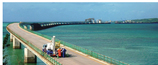
写真 - 7 伊良部大橋(平成23年12月初旬)施工状況全景(宮古島側から望む)
