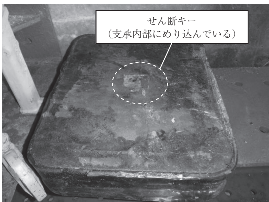
写真 - 3 支承せん断キーの陥没
