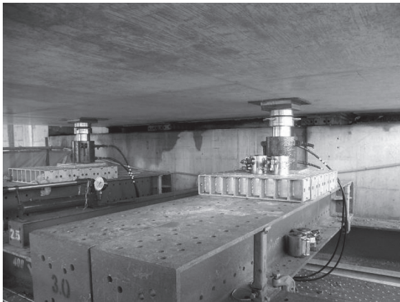
写真 - 6 鉛直ジャッキ
