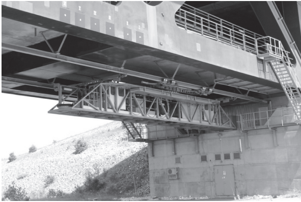
写真 - 14 保守点検用ゴンドラ
