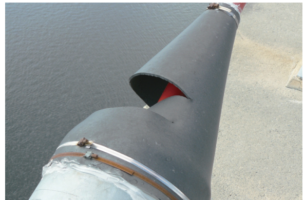
写真 - 10 止水カバーの破損
