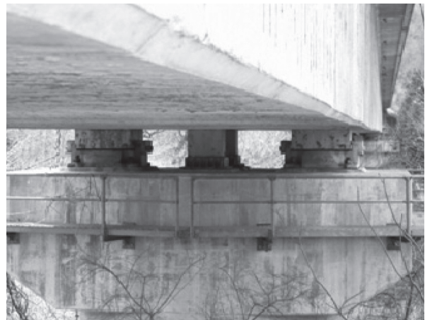
写真 - 4 地震後の中間橋脚の支承・ストッパー
