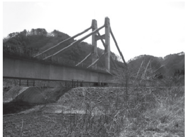
写真 - 3 地震後の小本川橋梁
