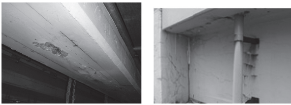
(a) かぶりコンクリートの浮き (b) ASRが原因と考えられるひび割れ
