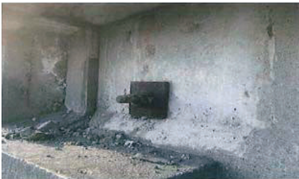
写真 - 3 横締め PC 鋼棒定着具保護コンクリートの脱落
