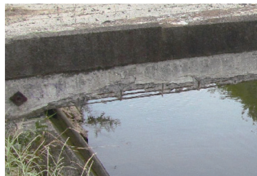
写真 - 5 プレテンション用 PC 鋼より線の露出
