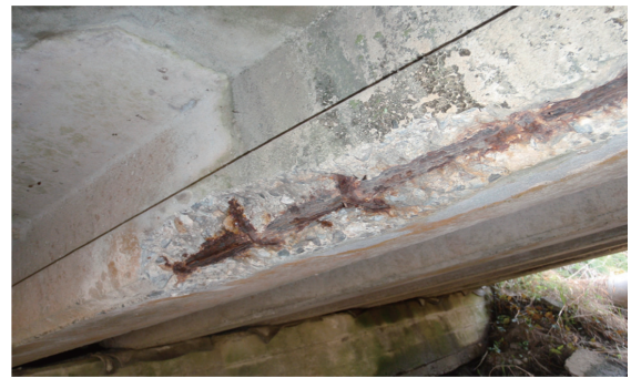
写真 - 4 アンボンド PC 鋼材の腐食
