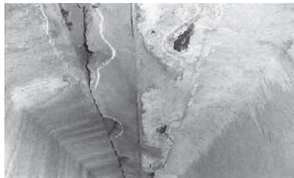
写真 - 2 中央分離帯下床版の損傷（一部脱落）
