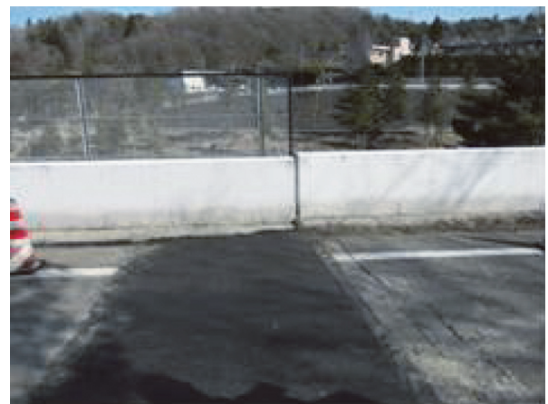
写真 - 2 伸縮継手に生じた段差
