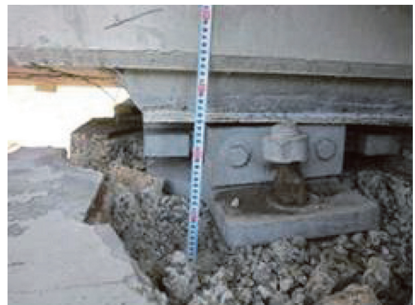
写真 - 1 沓座破損状況
