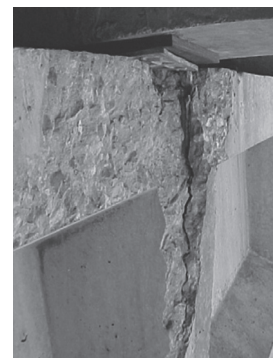
図 - 6 横梁上のコンクリート損傷
