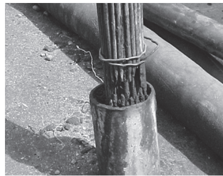
図 - 5 ハンガーシステムの腐食下における疲労破壊
