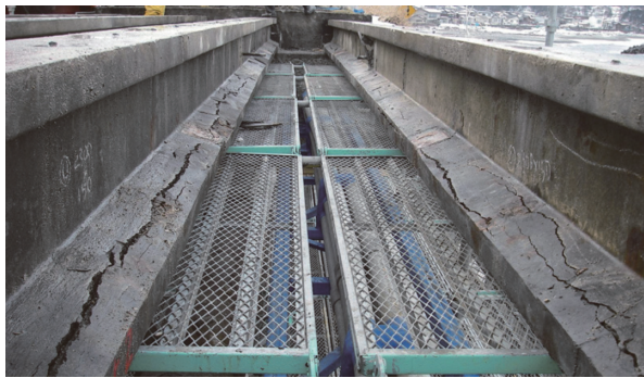
写真 - 2 塩害を受けた PC 桁
