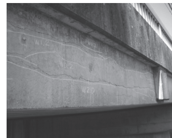
写真 - 6 主桁ウェブのひび割れ
