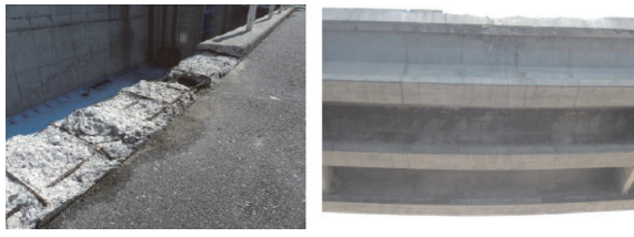
(a) 地覆部が圧壊 (b) 主桁に多数の曲げひび割れ 写真 - 14 第3径間の損傷状況
