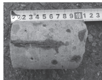
写真 - 7 コアのひび割れ状況
