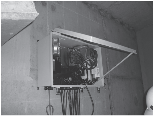
写真 - 6 計測システム設置状況
