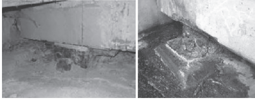
写真 - 2 鋼製支承腐食状況
