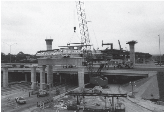
図 - 6 下支え式トラスを用いたスパン・バイ・スパン架設
