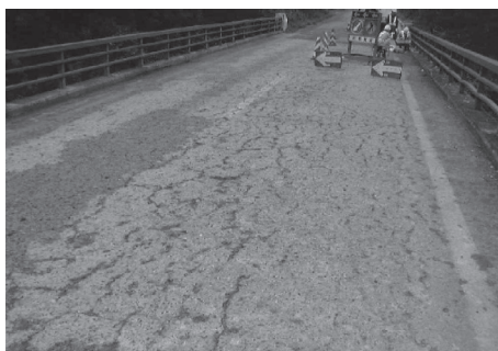
写真 - 1 床版上面の損傷状況
