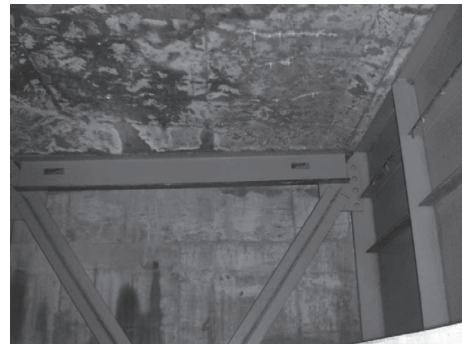
写真 - 2 床版下面の損傷状況
