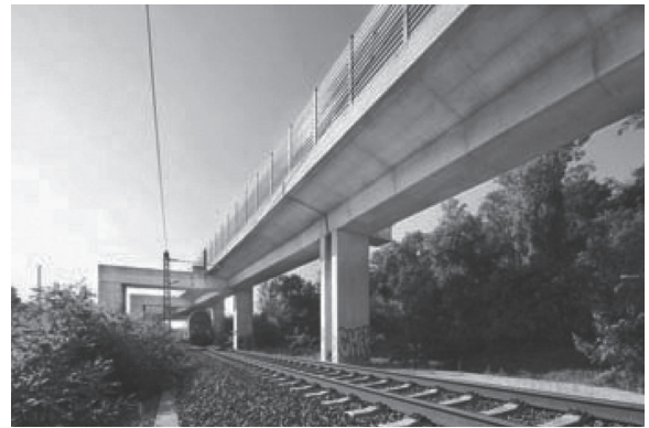
図 - 10 背割り式2列橋脚と門型ラーメンを用いた最新の交差構造
