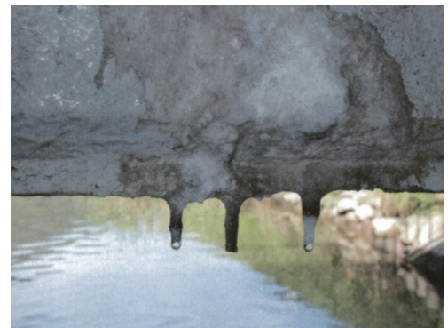
写真 - 4 主桁 - 遊離石灰状況
