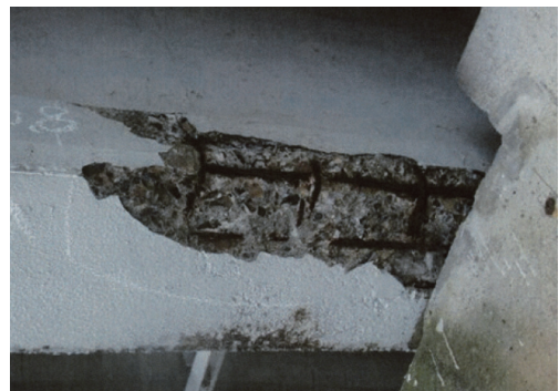
写真 - 3 主桁 - 鉄筋露出状況
