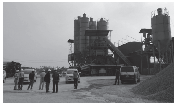
写真 - 12 現場に併設された生コンプラント
