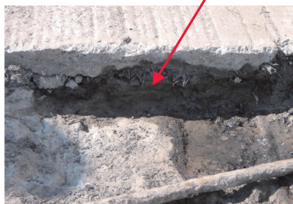
図 - 1 鉄筋コンクリート床版の劣化状況
