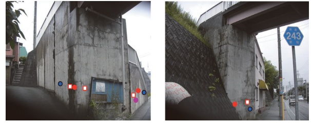
(a) A1橋台 (b) A2橋台 ○：コア採取箇所 (●)：圧縮強度試験, 静弾性係数試験, ●)：促進膨張試験 (●)：偏光顕微鏡観察 □：はつり調査箇所
