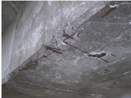
写真 - 2 桁底面の鉄筋腐食
