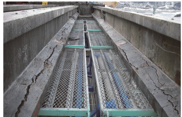
写真 - 6 PC-I 桁の劣化状況
