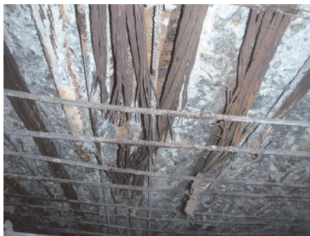
写真 - 4 PC 鋼材の腐食破断
