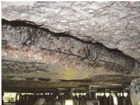
図 - 4 下面のはく離と隅角部の脱落
