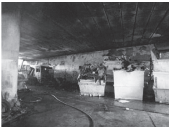
図 - 2 火災直後の状況
