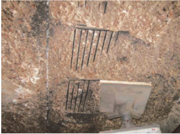
図 - 3 露出した鉄筋
